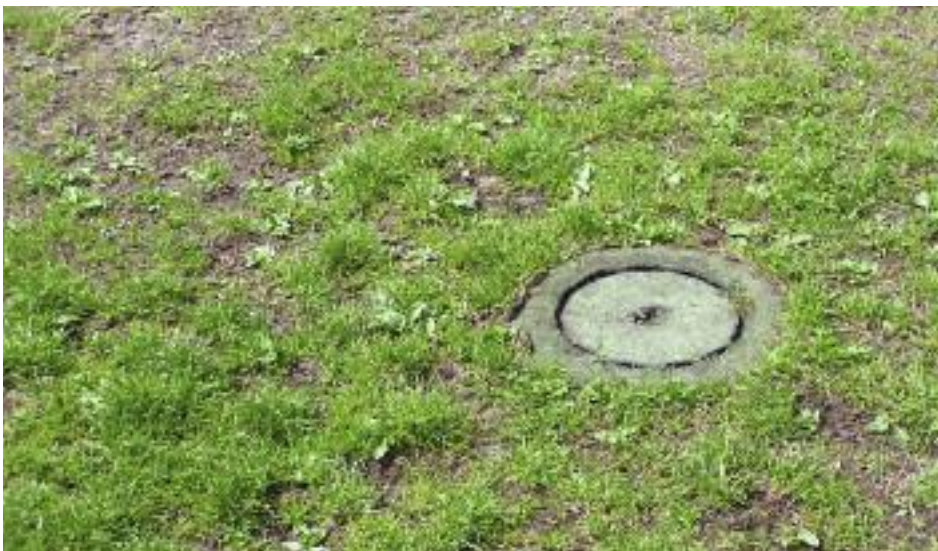
Nicht ebene Bewässerungsdeckel entsprechen nicht den Anforderungen an die Sicherheit
